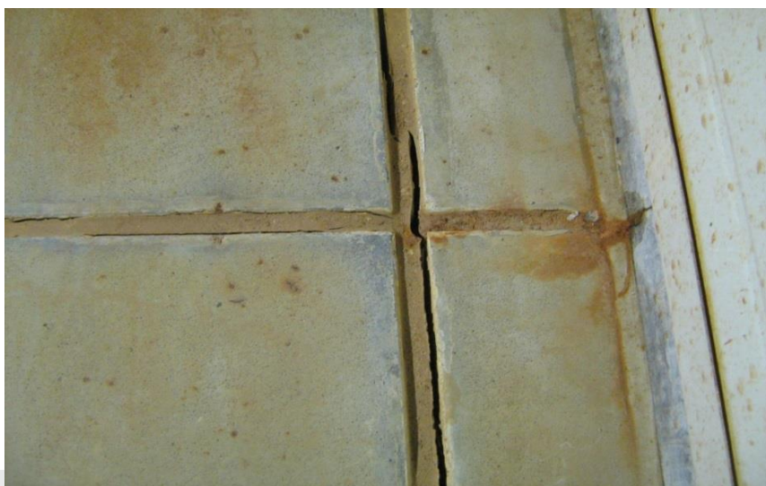
Foto: Beschadigde kitvoeg.
