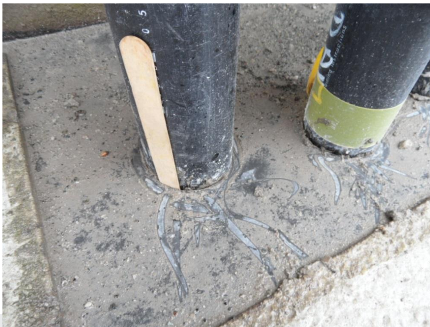
Foto: Voorbeeld van een niet-afgedichte doorvoer.
