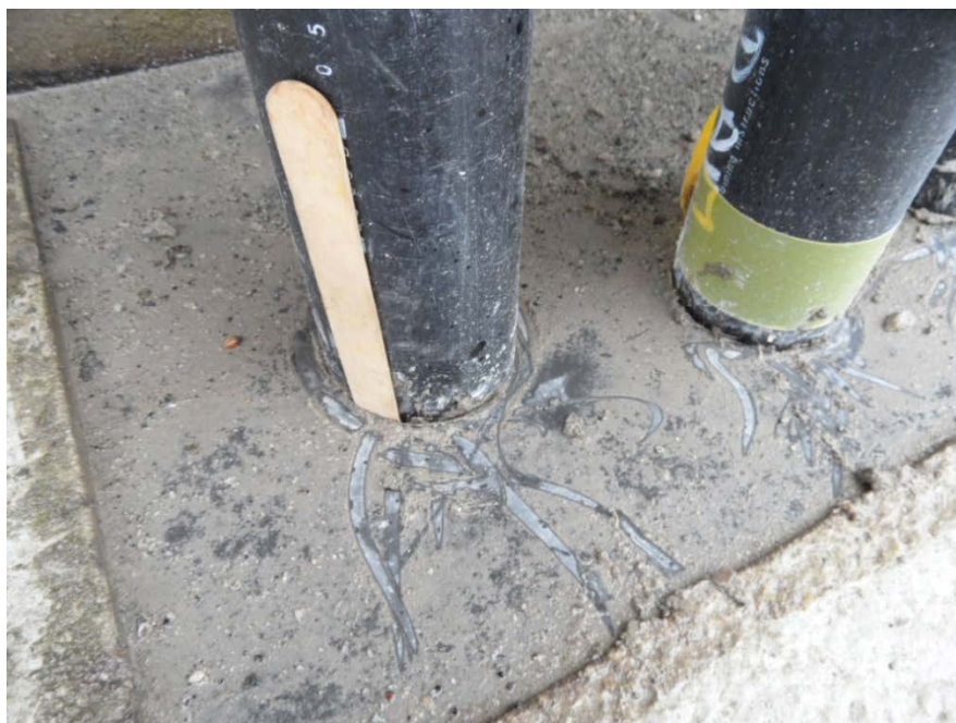
Foto: Voorbeeld van een niet-afgedichte doorvoer.
