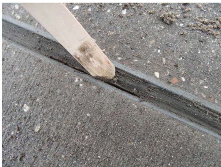
Foto: Afdichting is onthecht.
