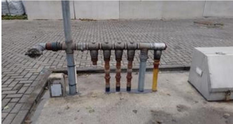
Foto: Voorbeeld manifold.
