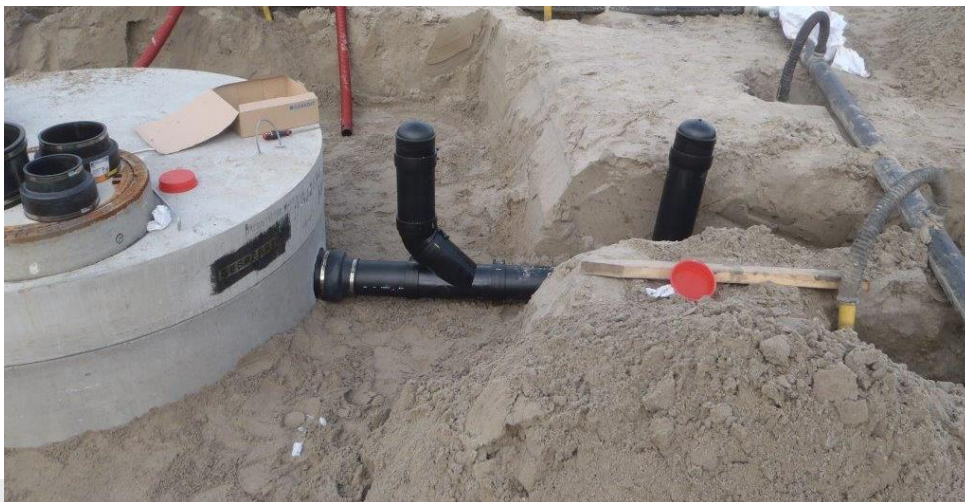
Foto: Voorbeeld van voorzieningen voor controle van de bedrijfsriolering op waterdichtheid. Aansluiting van de bedrijfsriolering (hdpe) op de prefab betonnen slibvangput.
