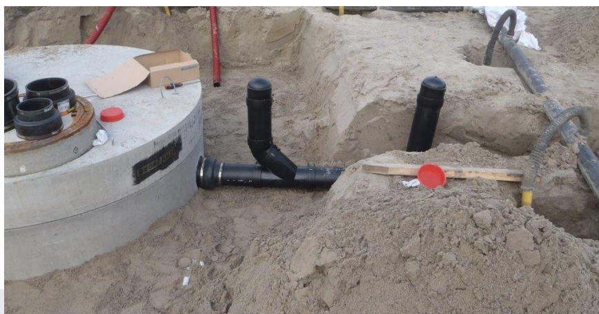
Foto: Voorbeeld van voorzieningen voor controle van de bedrijfsriolering op waterdichtheid. Aansluiting van de bedrijfsriolering (hdpe) op de prefab betonnen slibvangput.
