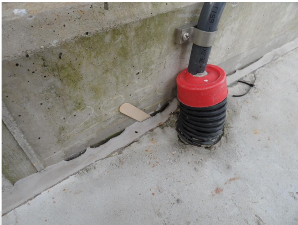
Foto: Gebrek aan afdichting.
