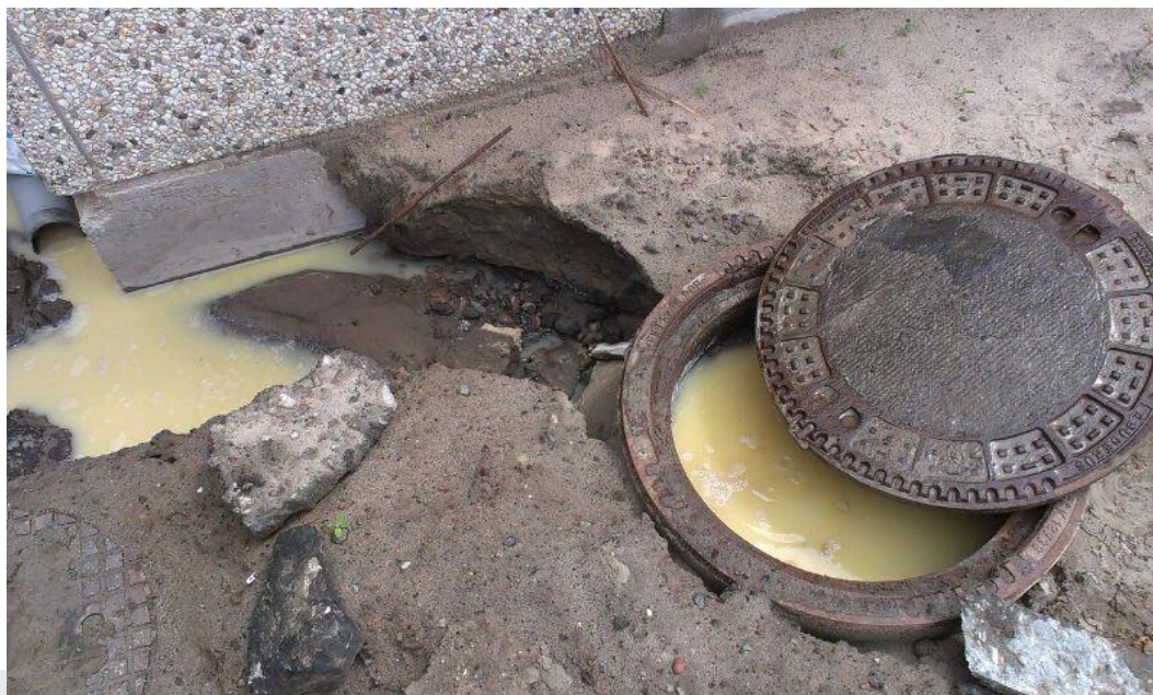
Foto: Verzakking in het rioleringsysteem.
