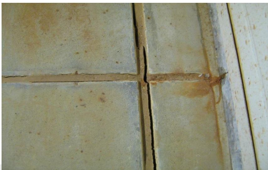
Foto: Beschadigde kitvoeg.
