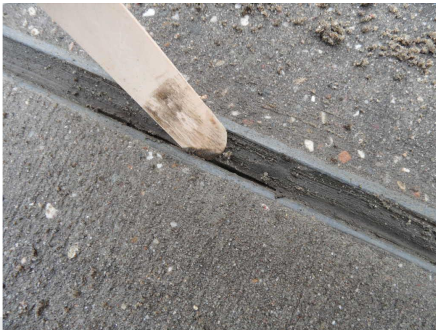
Foto: Afdichting is onthecht.
